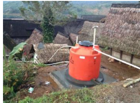
Gambar 18. Bak penampungan sekunder yang sudah terpasang
